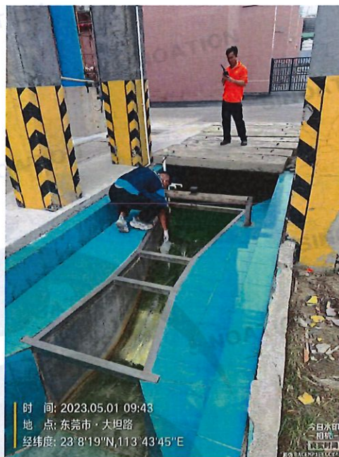
废水排放口 (DW001)
