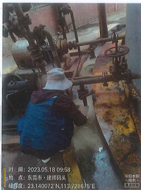
脱硫废水取水点
