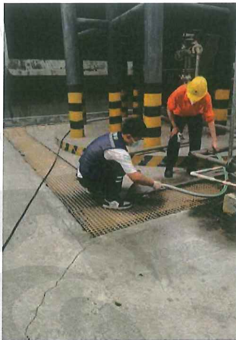
脱硫废水取水点
