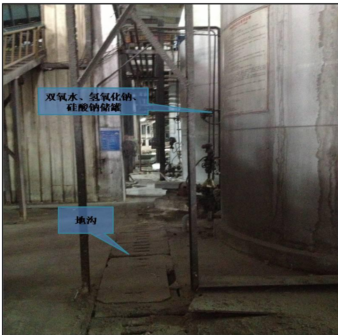
图 3-17 碎浆机一楼槽罐（制浆二科）截流情况
