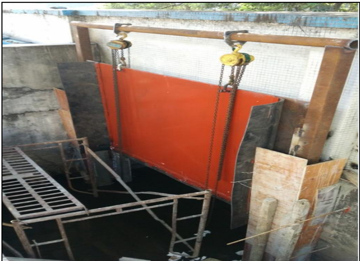
图 6-1 西侧雨水闸门现状图
